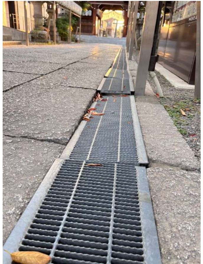
⑩ 直してもすぐズレるグレーチングの段差
