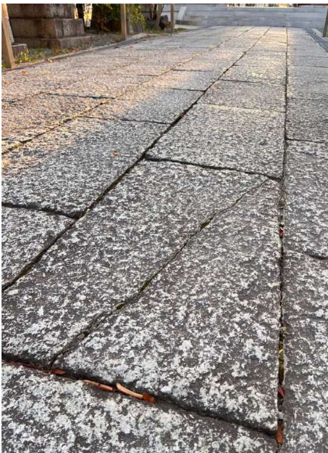
⑨ 主参道ひび割れ
