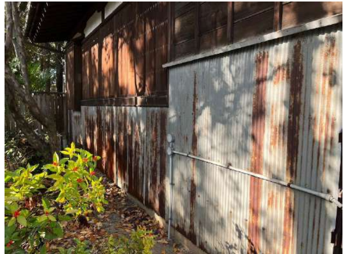
③⑦ 拝殿横の壁のトタンに錆び
