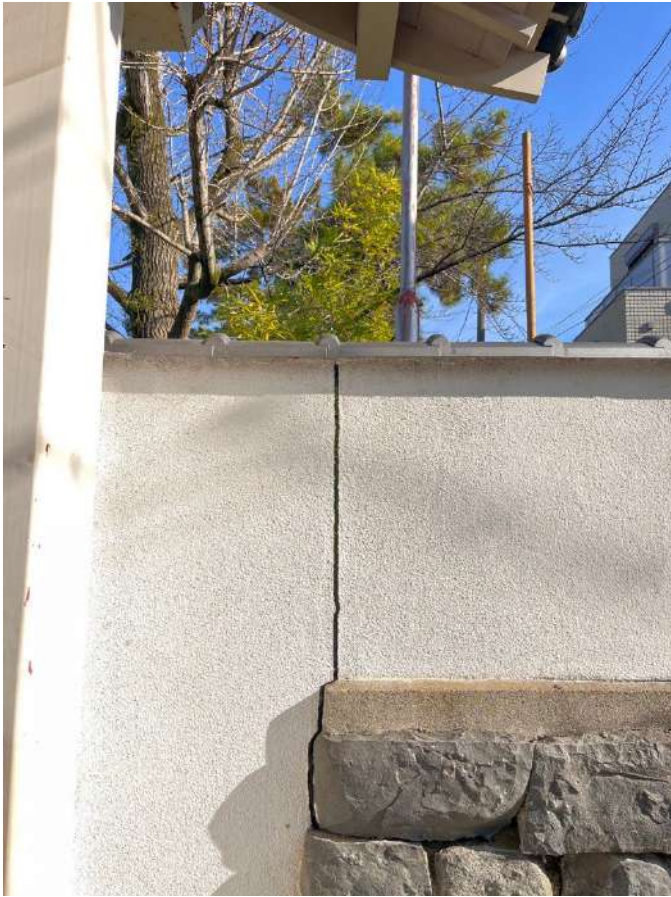
③⑤ 南門の壁に亀裂
