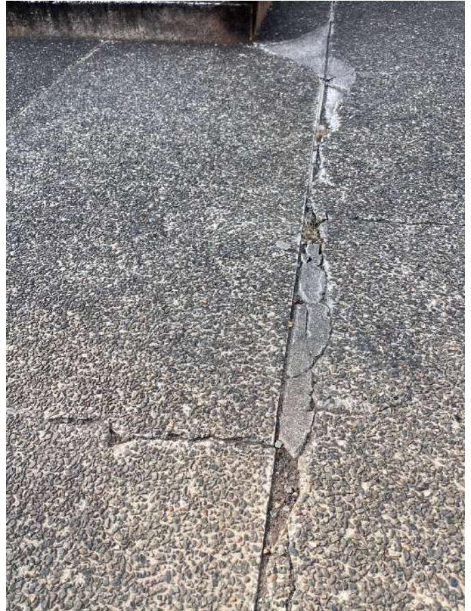
②⑩ 拝殿前ひび割れ、モルタル剥離
