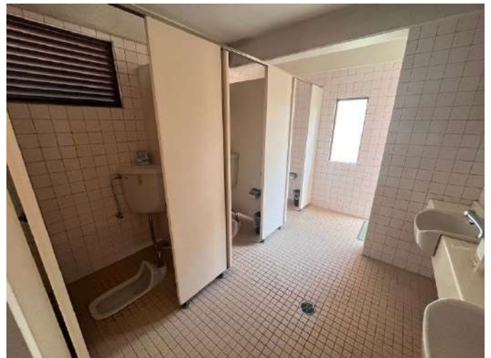
②⑨ 手すりもない和式トイレ (薄暗いため子供たちは使用しない)
