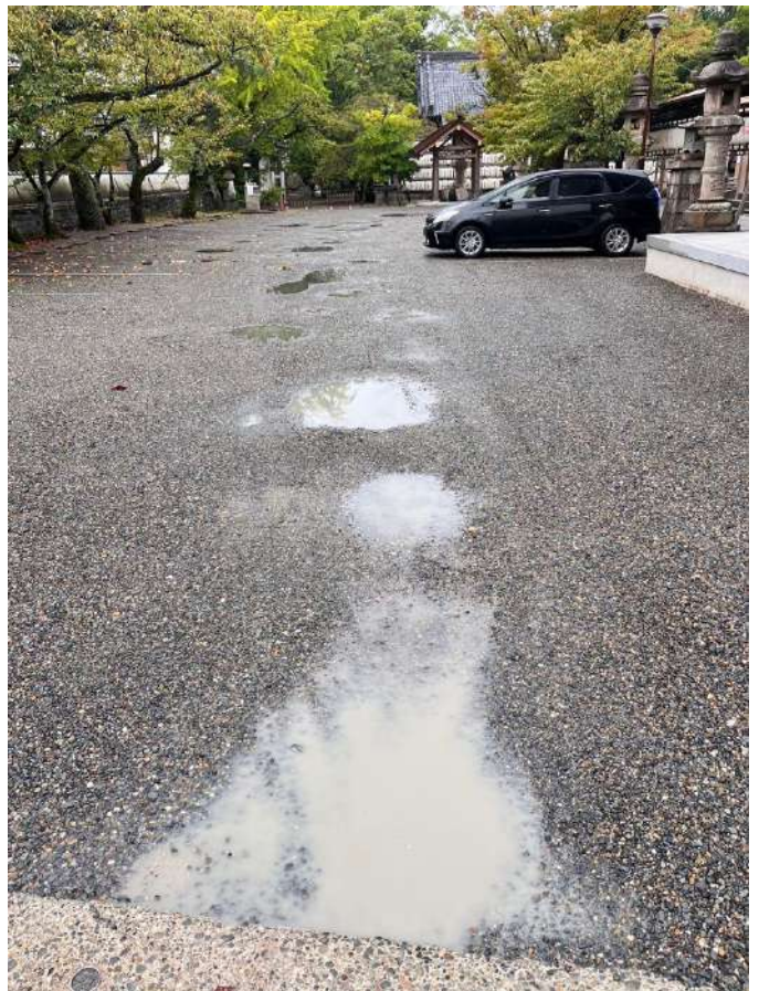
③⑪ 駐車場入り口水たまり、および砂利道路へ流出 (定期的に穴埋めするがすぐに戻る)
