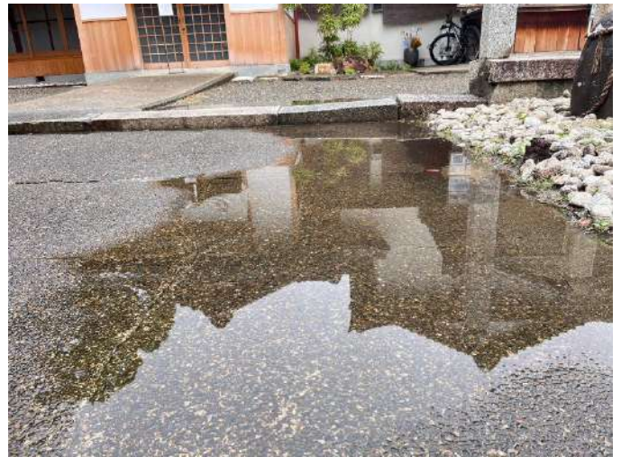
①⑨ 拝殿前地盤沈下により排水機能が停止した拝殿前 (雨に費はベビーカーや車いすでは社務所に知被けない)
