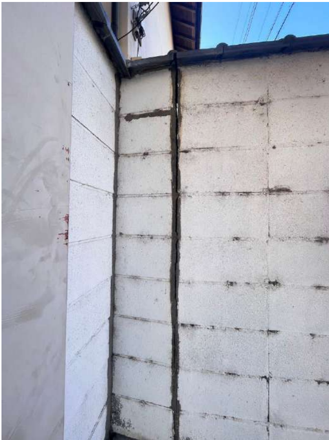
③⑩ 北門壁亀裂
