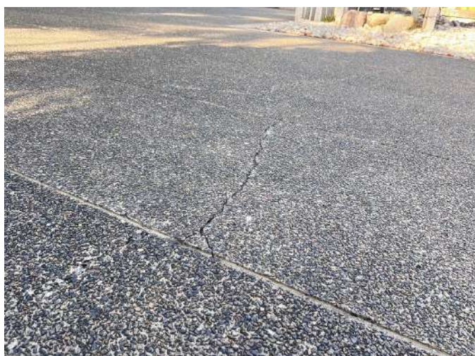
㉑ 拝殿前ひび割れ
