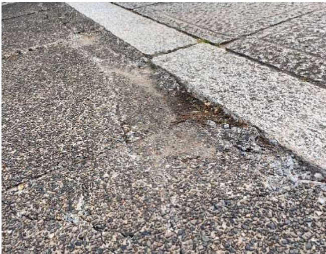
①⑥ 主参道の石畳とモルタルの境にできた ひび割れ、地盤沈下、モルタル剥離
