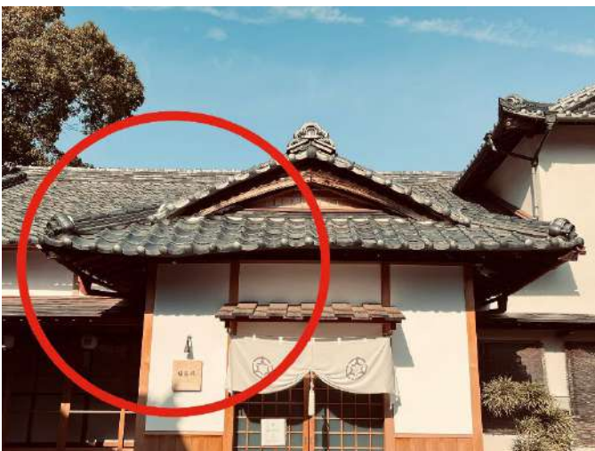
②⑦ 社務所玄関屋根崩れ
