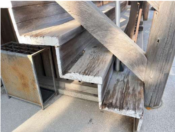
②⑤ 中臣神社側 拝殿階段の腐食(釘むき出し)
