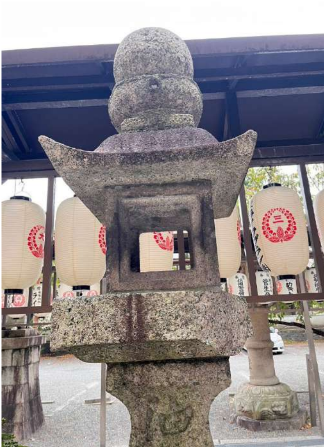
⑧ 中間土台が欠損した灯籠
