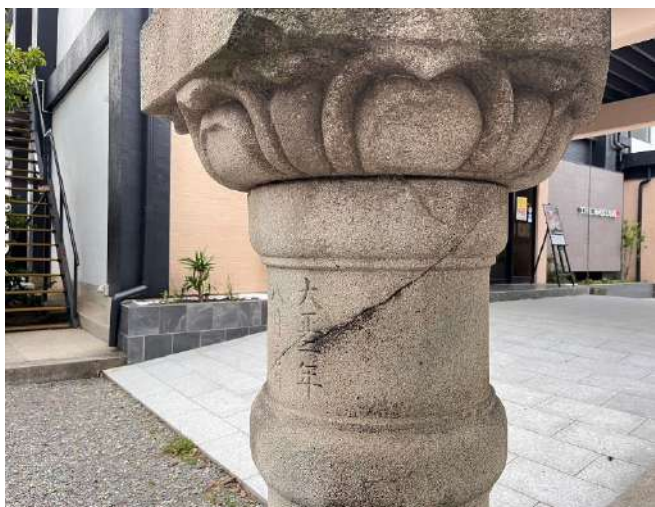
⑫ 灯籠に入ったひび割れ
