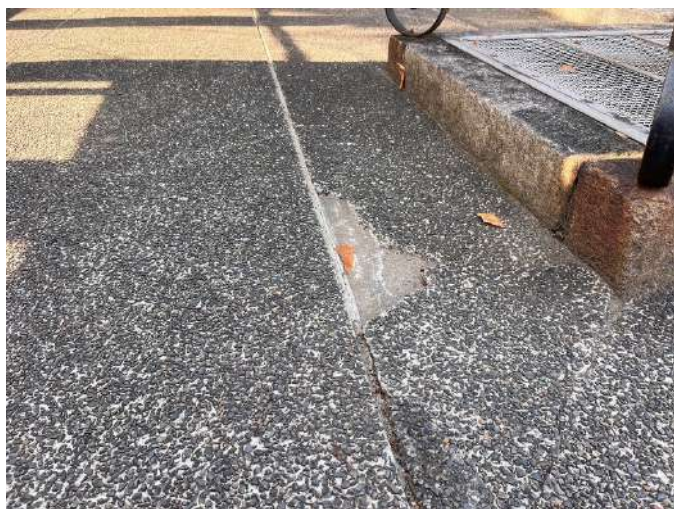
㉓ 拝殿前モルタル床の剥がれ
