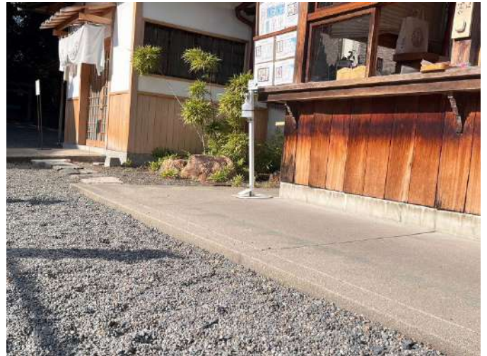
②⑧ 社務所前段差(つまずき救急車で運ばれる方2度あり)
