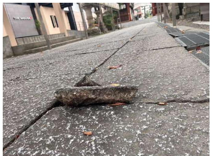
⑪ 主参道ひび割れ
