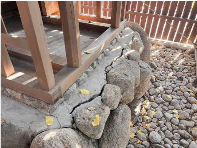
㉑ 母山神社の土台に亀裂と崩れ
