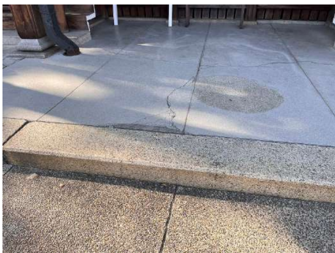
㉒ 拝殿前ひび割れ・躓きやすい段差
